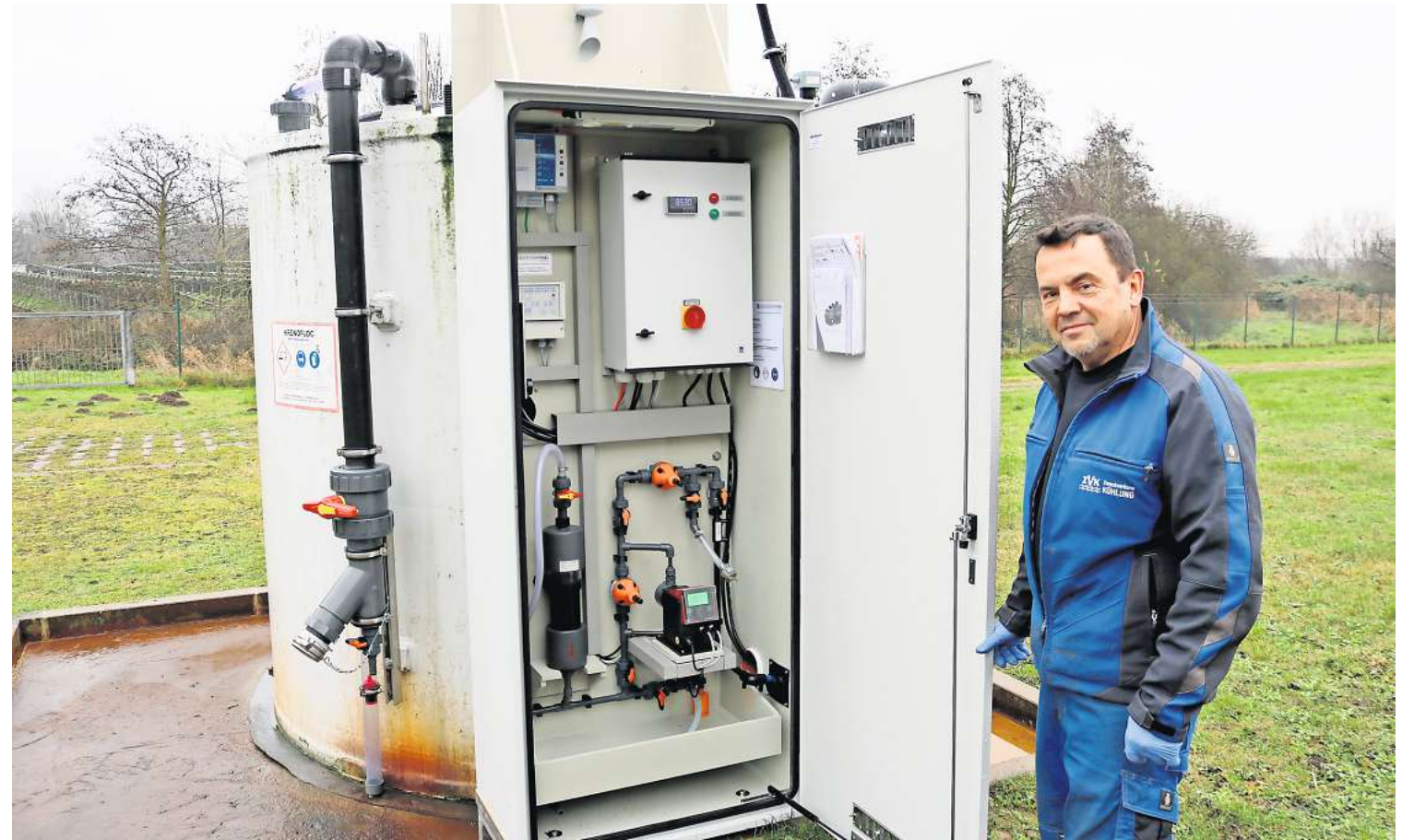
Klärwärter Henry Steinacker an der neuen Dosierungspumpe in der Kläranlage in Kröpelin.
