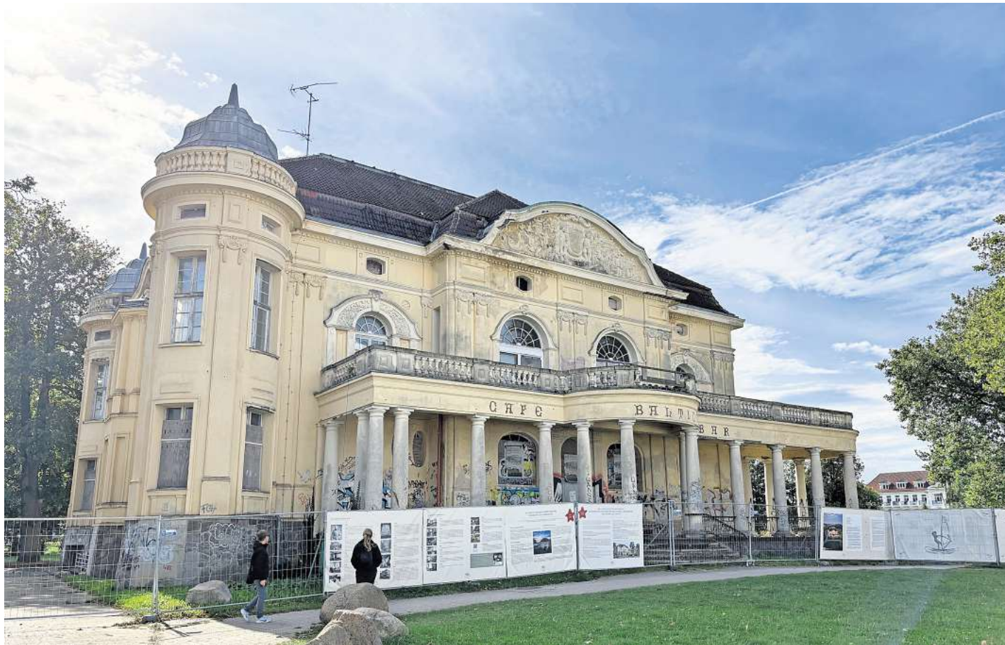
Die Villa Baltic in Kühlungsborn muss dringend saniert werden.
