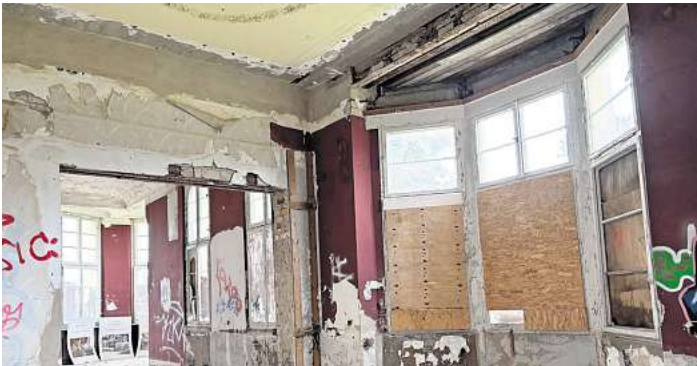
So sieht es zurzeit im Inneren der ruinösen Villa Baltic in Kühlungsborn aus.
