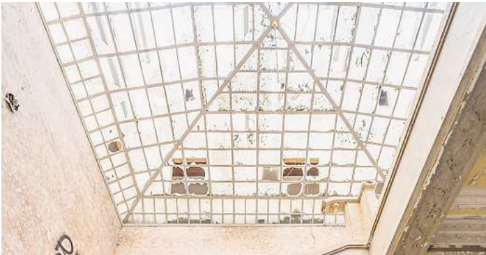
Die Glaskuppel in der repräsentativen Eingangshalle der Villa Baltic ist zum Teil kaputt. Es regnet rein.
