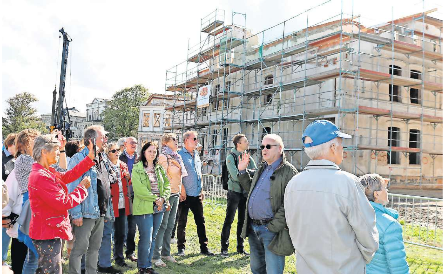
Klaus Klingler (3.v.r.) von der Entwicklungs-Compagnie Heiligendamm erläutert den Besuchern beim Tag des offenen Denkmals in Heiligendamm den Baufortschritt der Villa Seestern (im Hintergrund). FOTOS: ANJA LEVIEN
